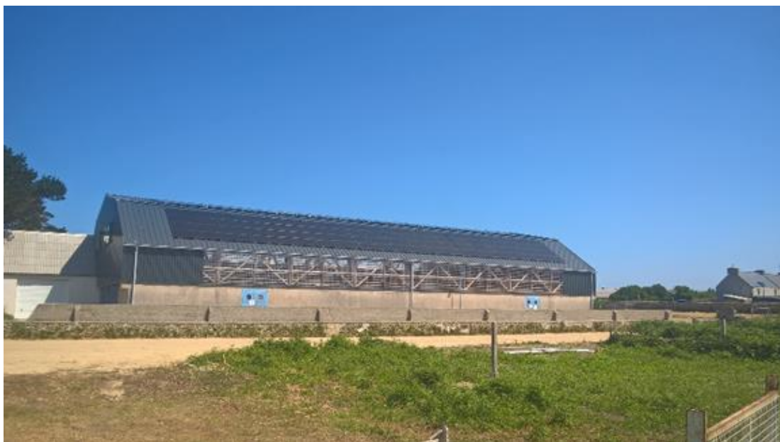
OUessant : Installation photovoltaïque sur la salle omnisports
