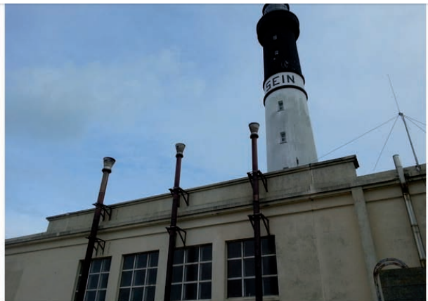
Les groupes électrogènes, au fioul, alimentent l'île en électricité. Les moteurs sont installés au pied du phare de Sein © Radio France - Mikhaël Roparz
